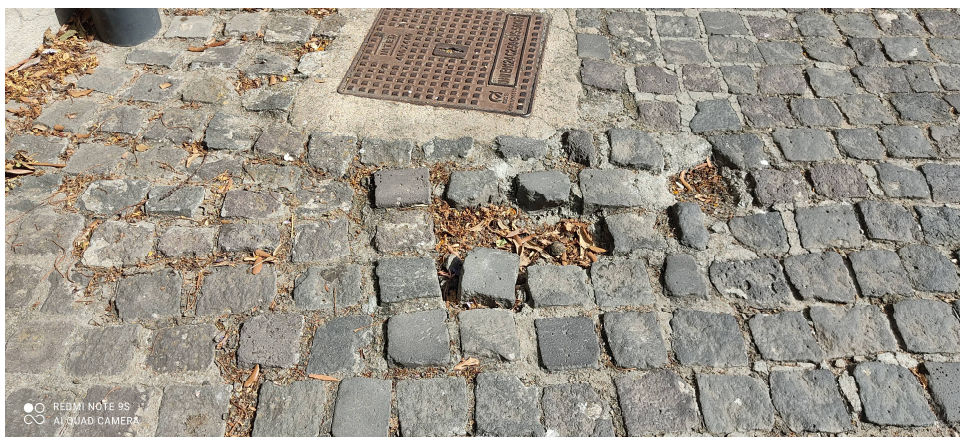
Foto 2 – Particolare in cui si evidenzia la mancanza dei cubetti
