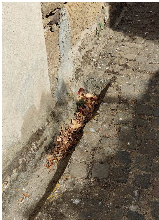
Foto 3 – Particolare in cui si evidenzia la quota elevata del manto stradale rispetto agli ingressi originari delle abitazioni.
