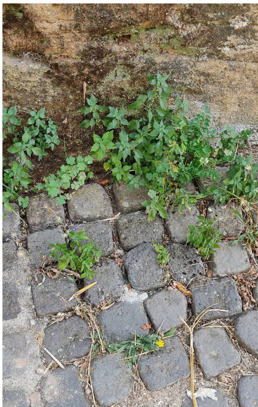
Foto 5 – Particolare degrado confine con le abitazioni (Umidità)
