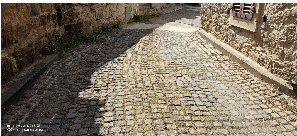
Foto 6 – Particolare sezione trasversale strada – da notare il convogliamento delle acque piovane a ridosso delle abitazioni
