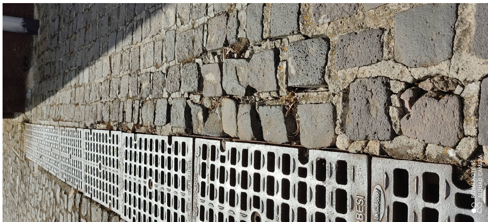
FOTO 1 – Particolare del degrado sul perimetro della griglia
