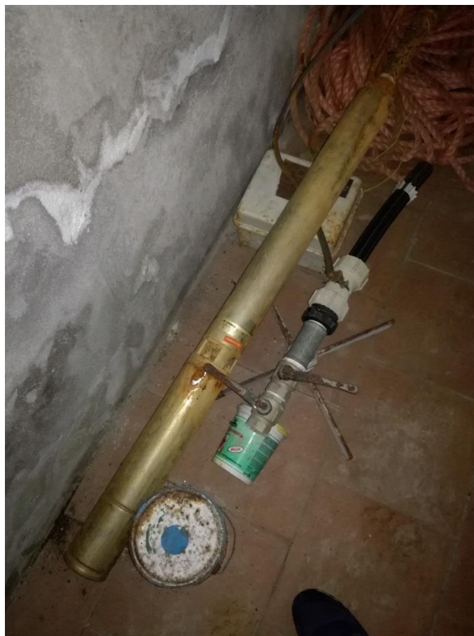
Figura 4: Elettropompa da pozzo dismessa.
