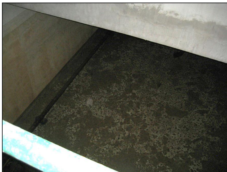
Figura 10: Particolare vasche serbatoio.
