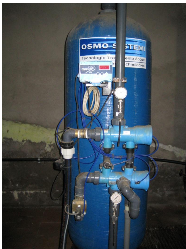
Figura 8: Particolare filtro a osmosi inversa.
