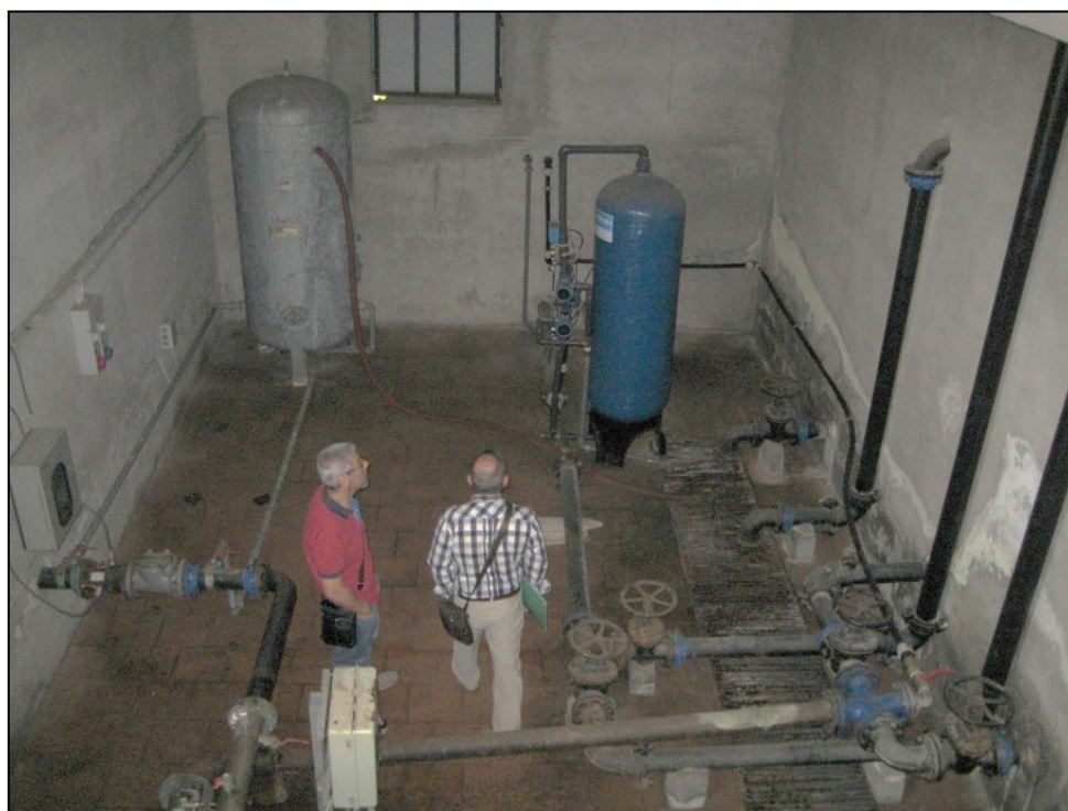
Figura 7: Camera di manovra serbatoio.
